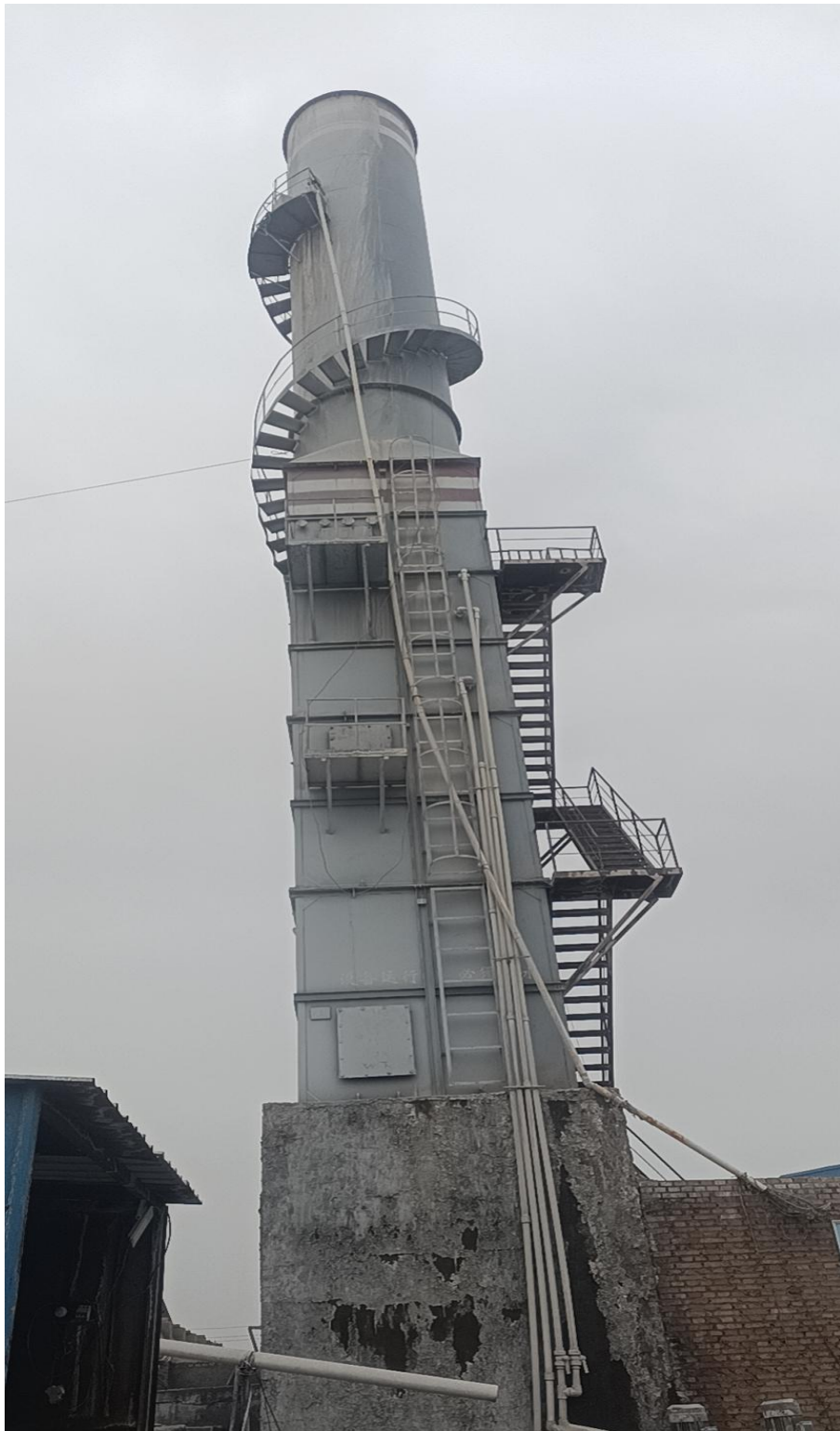
湿法脱硫除尘设备
