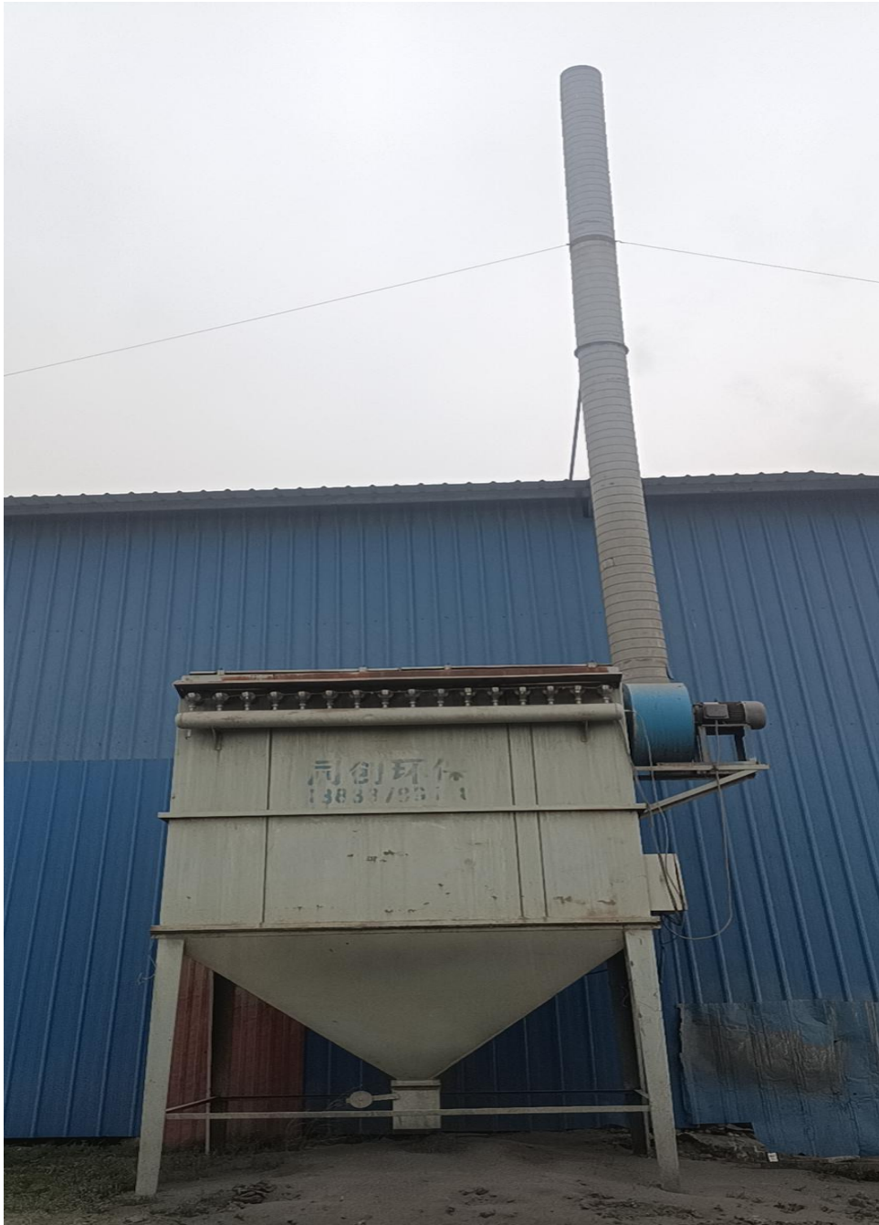
布袋除尘器+15m 排气筒
